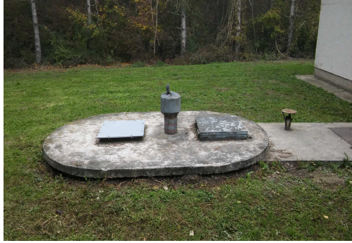
Außenansicht Vorschacht Bohrbrunnen
